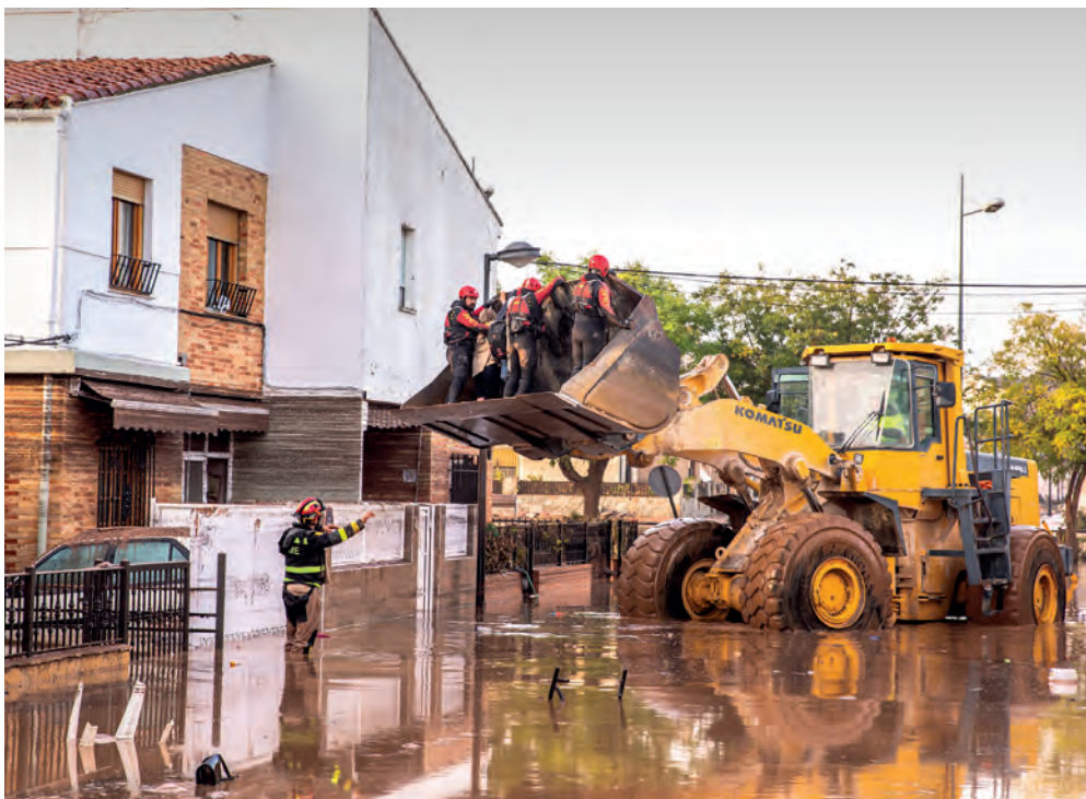
La DANA del pasado otoño en Valencia exigió la mayor intervención en la historia de la Unidad.
